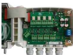
Le module relais est installé correctement et fonctionnel.
