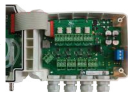
Módulo de relés correctamente instalado y funcional
