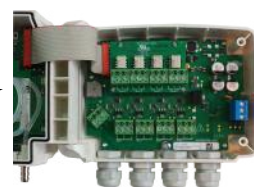
Relaismodule correct geïnstalleerd en functioneel.
