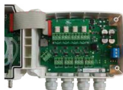
Módulo de 4 relés corretamente instalado e funcional.
